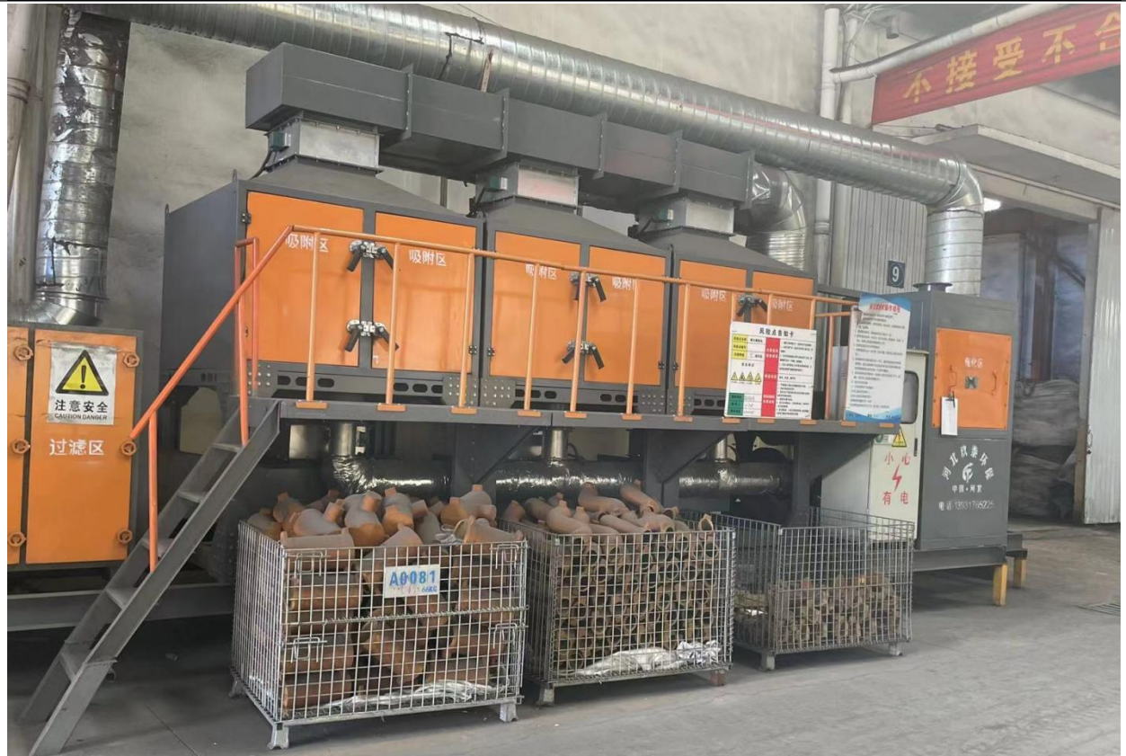
活性炭+催化燃烧装置
